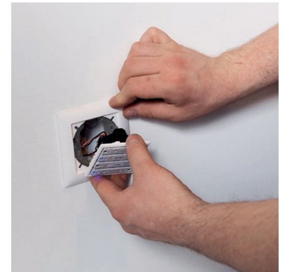
10 | Manutenzione smart building Più lavori di manutenzione grazie allo smart building
